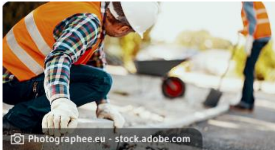
➤ Förderung kommunaler Straßenbau (LGVFG-KStB)
